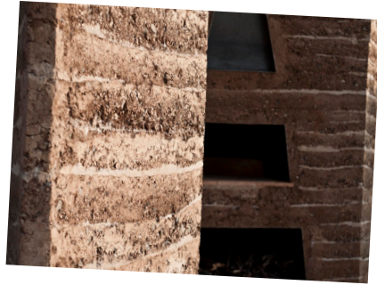
2) zoom sur la texture du mur, fissures, trous, irrégularités.
